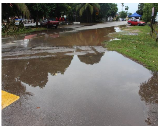
Gambar 1.7 Bahu Jalan Yang Lebih Tinggi Menyebabkan Air Bertakung
