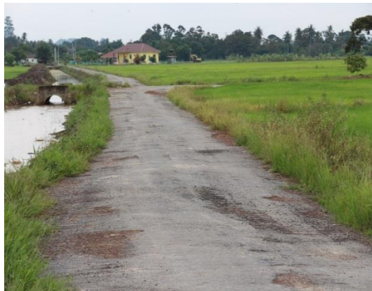
Gambar 1.12 Kerosakan Permukaan Jalan SSBR
