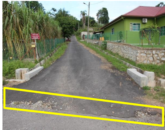
Gambar 1.19 Turapan Jalan Kurang Kemas
