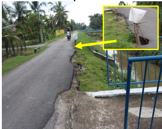
Gambar 1.13 Kerosakan Tepi Serta Bahu Jalan
