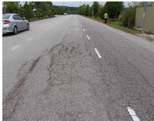
Gambar 1.6 Permukaan Jalan Rosak/Retak
