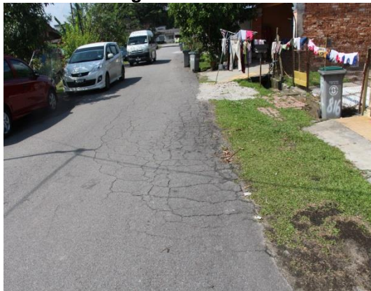
Gambar 1.37 Sebahagian Permukaan Jalan Yang Mengalami Keretakan
