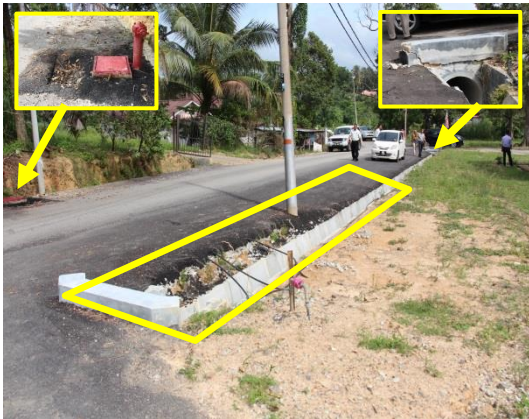
Gambar 1.18 Tembok Culvert Pecah, Turapan Kurang Sempurna Dan Lubang Akibat Turapan Pihak Lain
