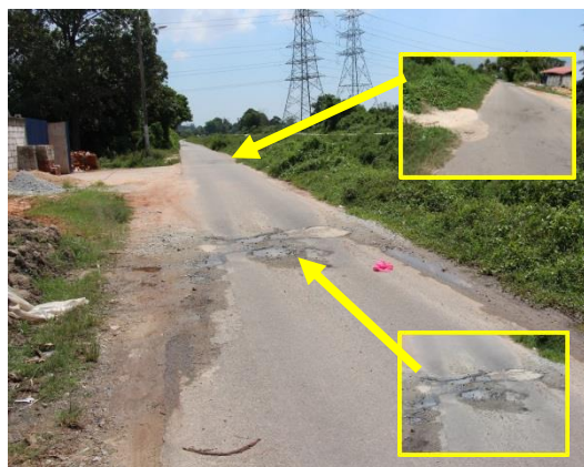
Gambar 1.11 Antara Permukaan Jalan Yang Rosak
