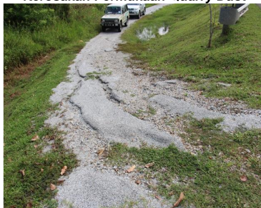
Gambar 1.9 Kerosakan Permukaan Quarry Dust
