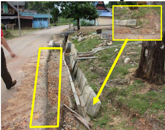
Gambar 1.20 Bahagian Hujung Longkang Yang Tidak Kemas Dan Bahu Jalan Yang Rendah
