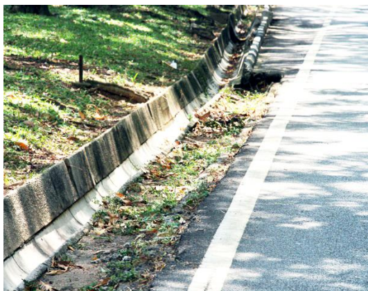
Gambar 1.3 Bahu Jalan Rendah Dan Merbahaya
