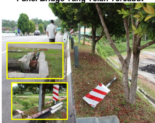
Gambar 1.32 Panel Bridge Yang Telah Tercabut
